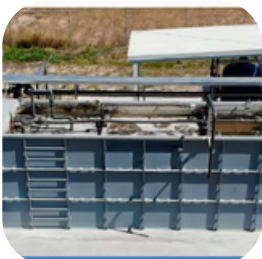
Système MBR réacteur biologique + filtration par membrane MBR System: Biological reactor + membrane filtration
